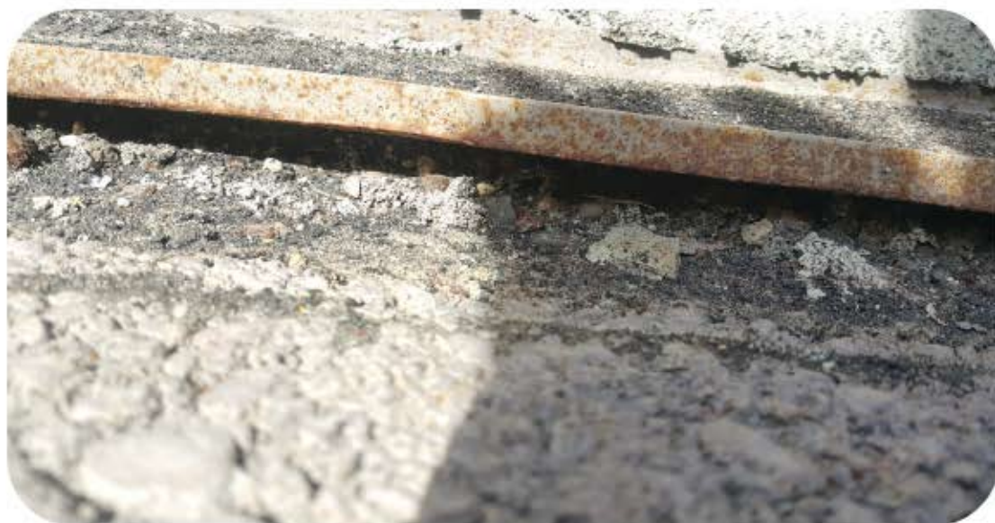
فاصله ایجاد شده بین کف مخزن و دیواره فنداسیون
